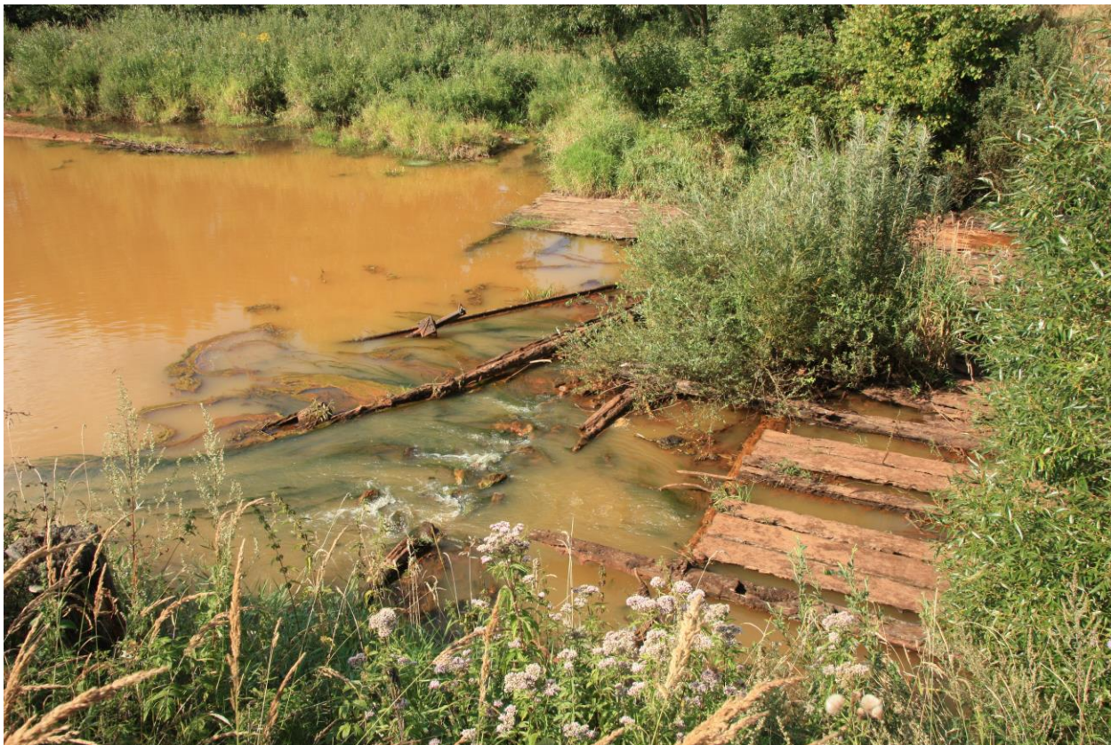
Fot. 3. Pozostałości jazu w miejscowości Siedlów. Lipiec i sierpień 2015 r. Widoczny niemal zupełny brak przepływu w rzece. Widoczna też silnie zanieczyszczona zawiesziną woda.
