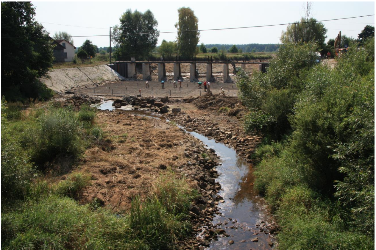
Fot. 5. Nieprawidłowy remont jazu w Kołońcu. Widoczny niemal zupełny brak przepływu.
